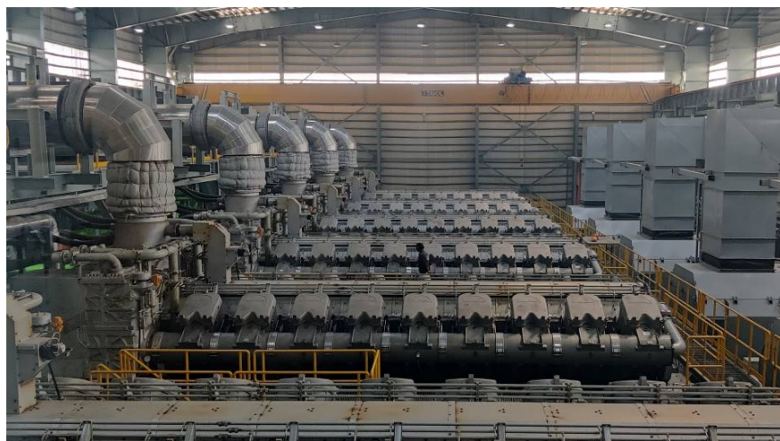
Das Kraftwerk in Thakurgaon (im Bild) wird von sechs MAN 18V48/60TS-Motoren mit einer Gesamtleistung von rund 125 MW angetrieben
