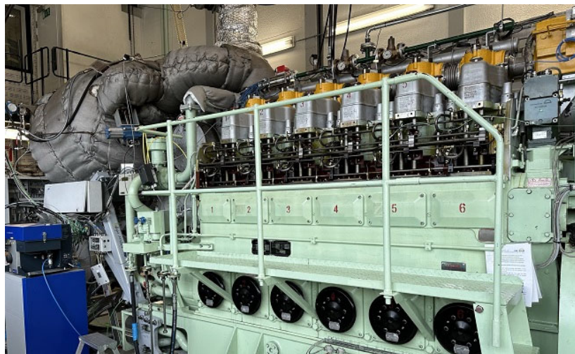
Ansicht von der Teststation in Frederikshavn
